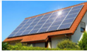
Güneş enerjili elektrik paneli
